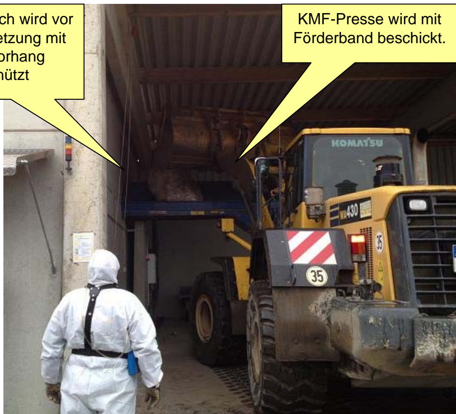
Bild 3: Überwachung der Beladung des Förderbandes (Nr. 3)
