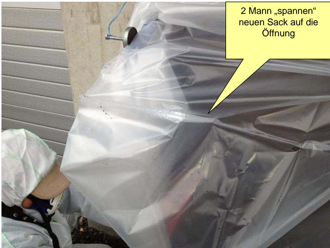
Bild 8: Neuer Sack an Ausgangsführung angebracht (Nr. 9, 13, 17)
